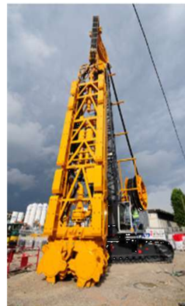
Abb. 4 zeigt eine Schlitzwandfräse der Firma Bauer, die im Felsgestein eingesetzt wird und auch einen Steinblock im Schlitzwandgraben beseitigen kann.
