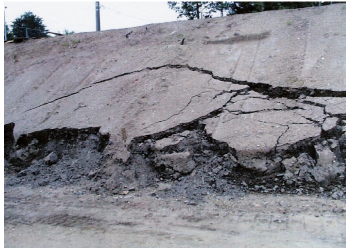
Abb. 62 zeigt den Hangrutsch im Damm durch Fehlstellen am Dammfuß.
