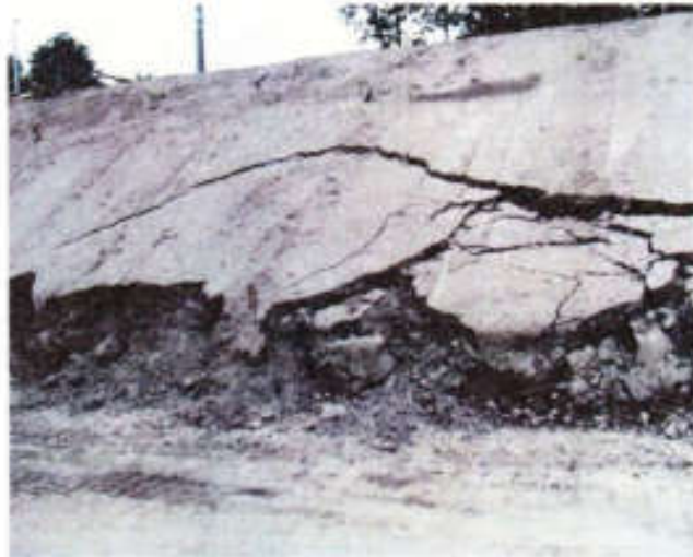
Abb. 139 soll nach Literatur [A] einen «Böschungsrutsch infolge unzureichender Bodenverdichtung» zeigen.
